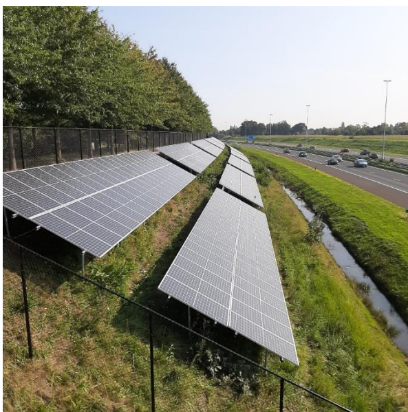
Zonnepanelen op het talud van A58 © DuurSaam
