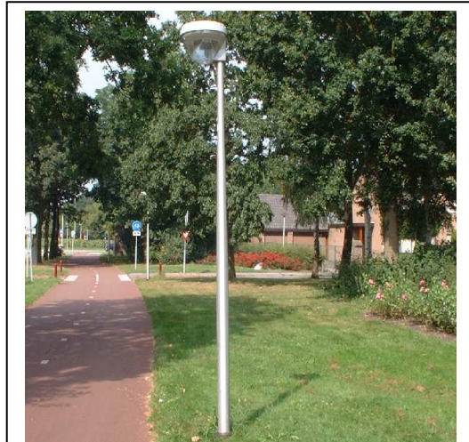
Afbeelding 10: Een lichtmast die voldoet aan het hoge niveau
